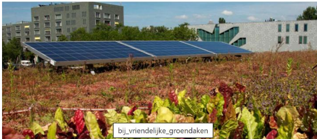
ZONNEPANELEN (OP EEN GROEN DAK)
